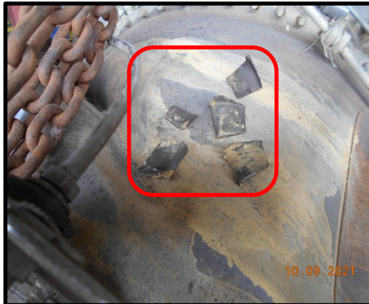
Fotografía No. 13 Vista de los alabes fracturados de las ruedas de la sección de potencia.
